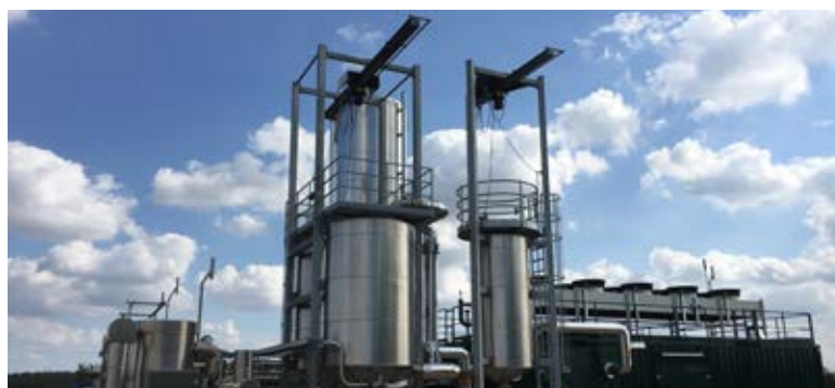
L'installation de production de biogaz à Parum (DE) prépare du biogaz brut à injecter dans le réseau. (Photos: NGF Nature Energy/ IWB)
