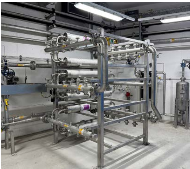
Installation à membrane de la nouvelle centrale de biogaz certifiée naturemade star à Bâle (photo : ProRheno)
