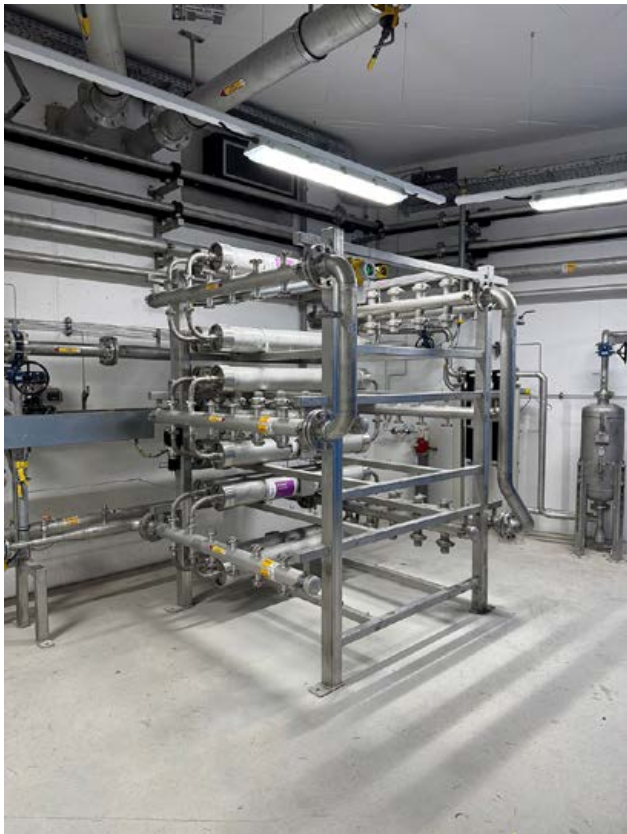
Membrananlage der neuen naturemade star zertifizierten Biogasanlage in Basel (Bild: ProRhenio)
