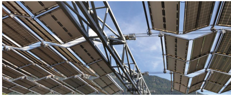
Solar-Faltdach über der Kläranlage in Chur.
