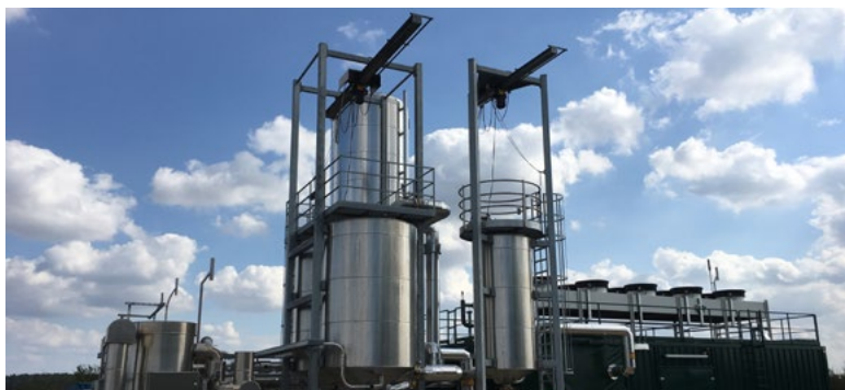
Die Biogasaufbereitungsanlage in Parum (DE) bereitet Rohbiogas für die Einspeisung ins Gasnetz auf. (Fotos: NGF Nature Energy/ IWB)
