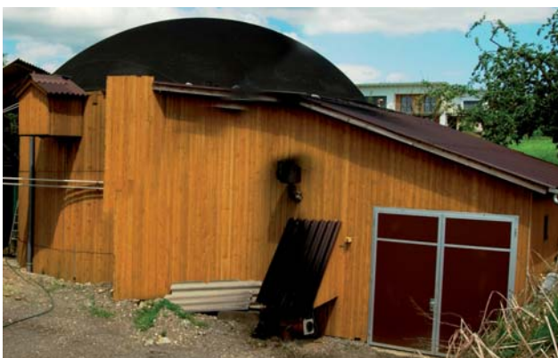
Installation à biogaz de Lampart, Mauensee, naturemade star
