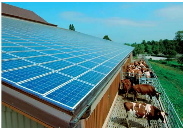
Installation photovoltaïque Aeberhard à Barberêche, naturemade star
